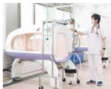
病院内のミストシャワーによる特殊入浴設備
